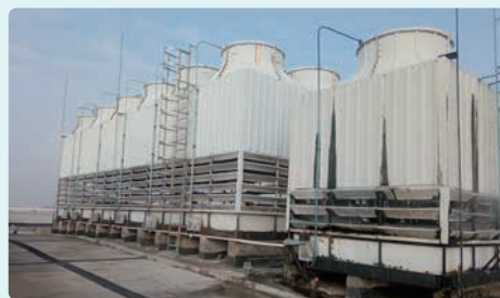
图：凯茂生物中水回用项目
